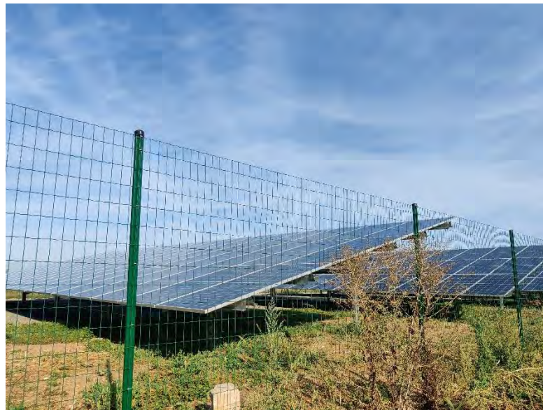
Photovoltaikanlage in Munchouse (Quelle: Collectivité européenne d'Alsace ENGIE PV )
