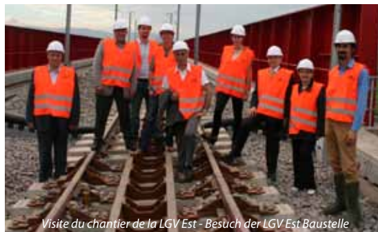
Visite du chantier de la LGV Est - Besuch der LGV Est Baustelle
