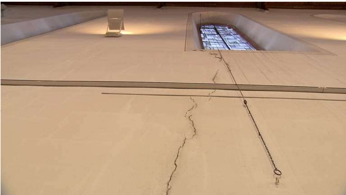
Lange Risse durchziehen die Wand der Friedenskirche in Kehl: In der Grenzstadt haben viele Menschen zu spüren bekommen, dass Tiefen-Geothermie auch Risiken birgt. Ein Projekt der Firma Geoven/Fonroche hatte 2019 und 2020 im Raum Straßburg Erdbeben ausgelöst und viele Gebäudeschäden verursacht.
